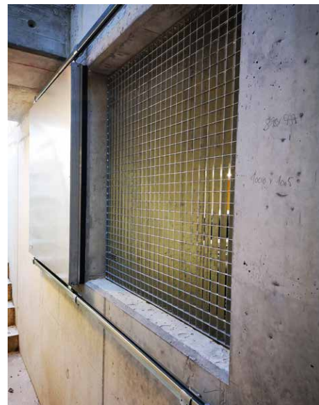
Die stehende, schiebbare Rauchklappe in offener Position.
